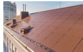
REFERENCE : PANNEAUX PHOTOVOLTAÏQUES
