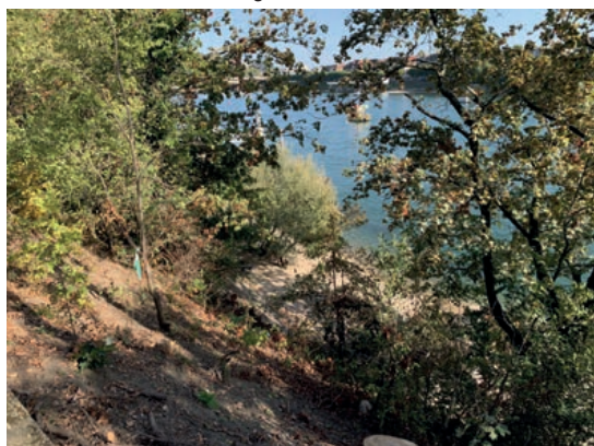
Bewuchs in der Böschung, Aufnahme 2023
