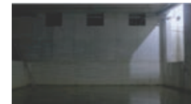
Bild Begehbare Löschwasserbecken 2: AWB24
