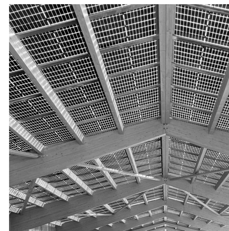
panneaux photovoltaïques translucides référence: déchetterie à Orbe, 2023.
