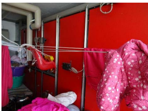
Monobloc de ventilation salle de gym
