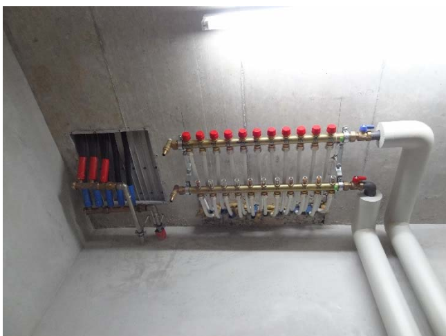
E3 : Installations techniques
