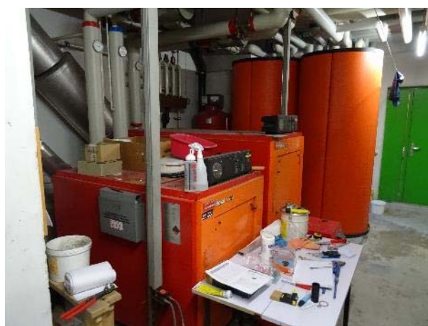
2 Chauffe-eaux de 600 litres
