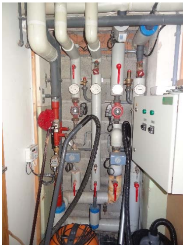
E3 : Installations techniques
