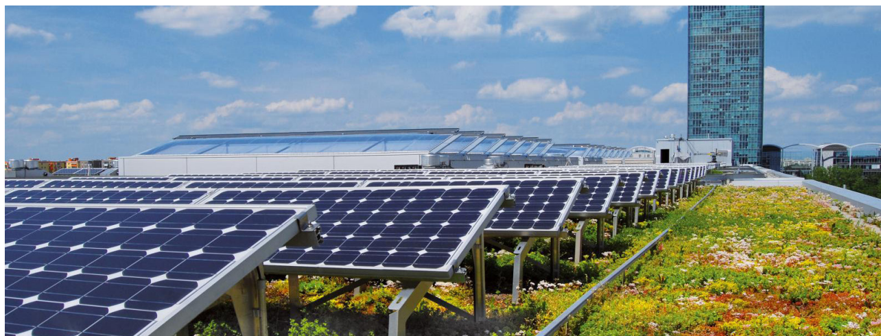
Esempio di un tetto estensivo combinato con un impianto fotovoltaico
