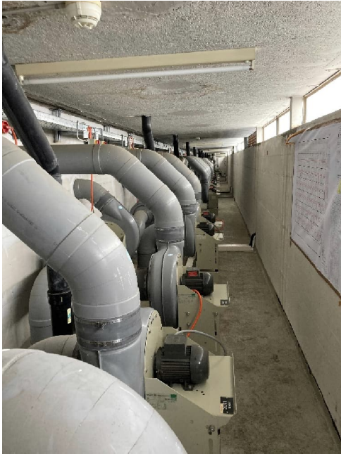
Image: Installations de ventilation dernier étage
