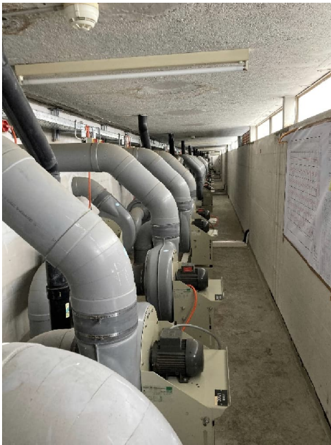
Bild: Lüftungsanlagen Dachgeschoss
