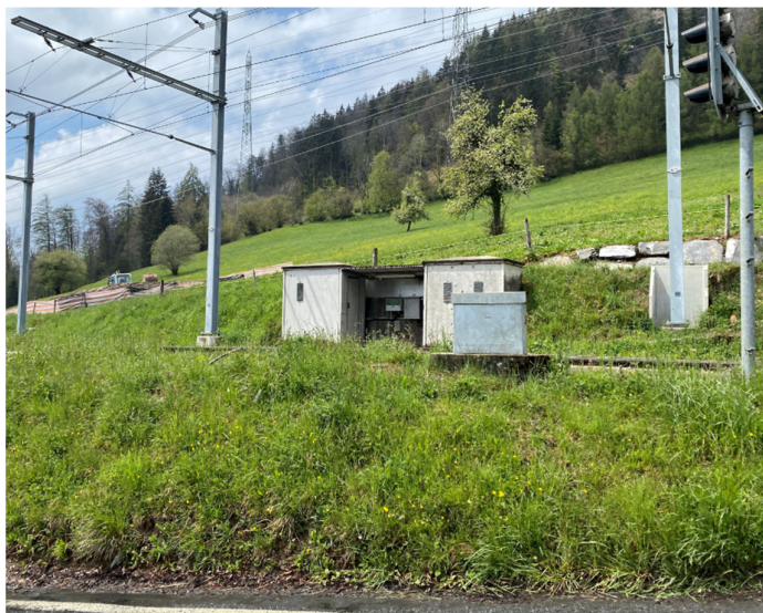
Figure 3 - Locaux techniques de la gare de Sendy-Sollard au km 9.200
