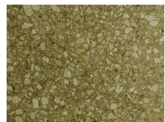
Der Gussasphalt der Fuss- und Veloweg ist unterschiedlich pigmentiert.
