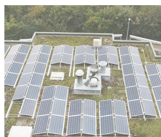
Panneaux solaires et végétalisation extensive
