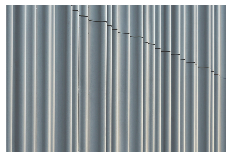
Faserzementplatten unregelmässig gewellt
