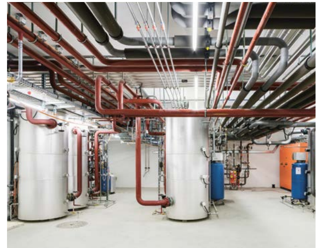
2_ Der Energy Hub im Untergeschoss des NEST.
